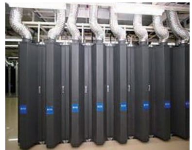
在江蘇，採用精確送風技術降低機房空調能耗
