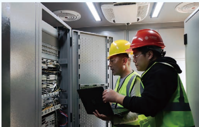
工作人員進行智慧城市設備維護
