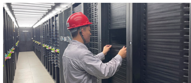
◎ 补齐盲板避免冷量损失
