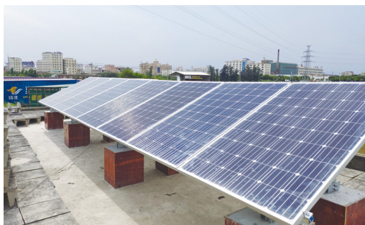
福建公司利用太阳能 + 基站一体化能源柜开展太阳能叠光试点
